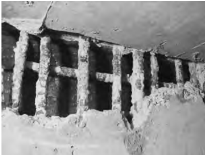
まったくコンクリートが充填されていない鉄骨梁
