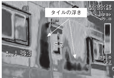
外壁タイルの浮き
