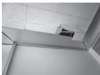
天井の部分的な脱落
