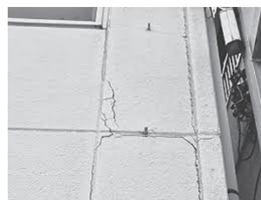
ALK外壁の損傷
