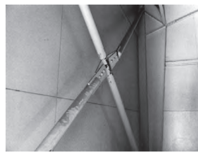
鉄骨圧縮ブレースの座屈
