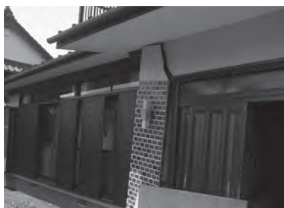
木造壁の変形、きれつ
