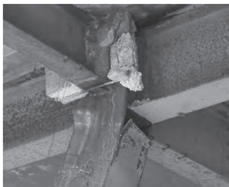
日の字柱の破断
