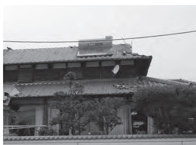
木造屋根瓦の脱落
